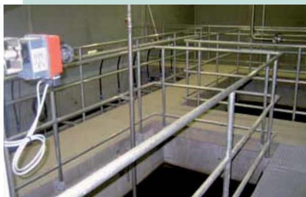
Kläranlage Schloss Rosenau – Innenansicht
