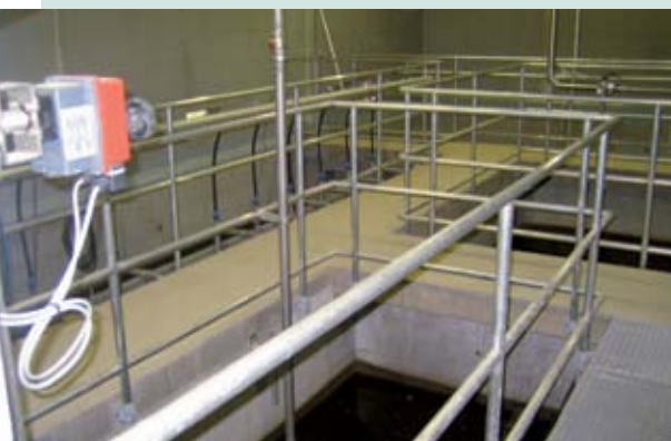
Oczyszczalnia ścieków Zamek Rosenau - widok wewnątrz
